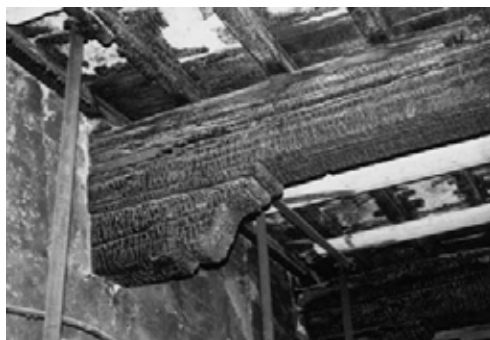
Figura 3.12: Solai di legno non crollato a seguito di un incendio.
