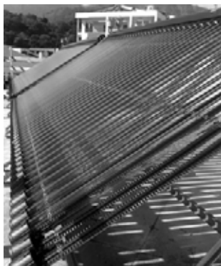
Figura 4.16: Vista generale del campo solare a tubi sotto vuoto installato su una porzione di terrazza dell'Istituto CNR-ITAE di Messina.
